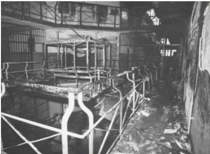
Fotografia nr 3. Zdemolowany korytarz jednego z pawilonów mieszkalnych
